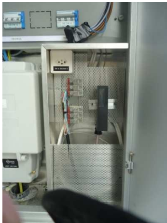
BEP im Zähler-Aussenkasten
