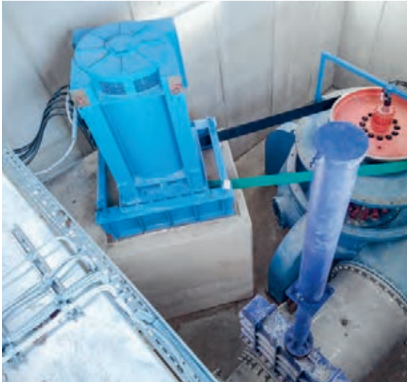
Maschinenraum im Kraftwerk Packerbach
