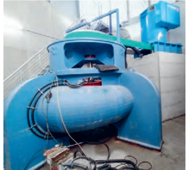
Turbine im Maschinenraum
